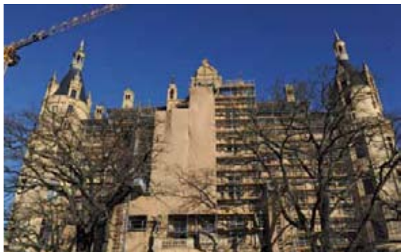
Die sandfarbenen Gerüstplanen an der Südfassade des Schlosses sind schon fast komplett gefallen.
